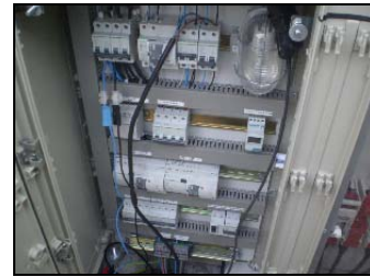
Medidas in situ de un cuadro de alumbrado y equipo
