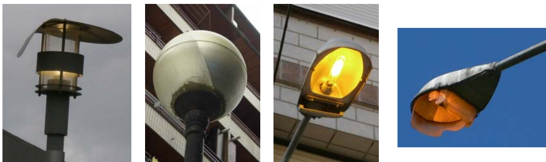
Puntos de luz en condiciones de mantenimiento deficientes
